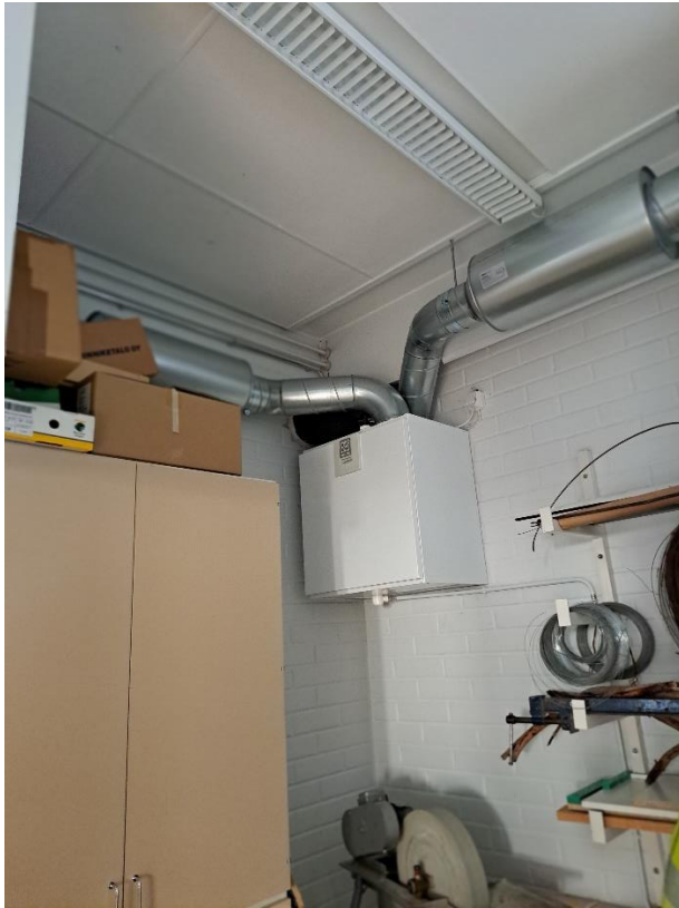
Kuva LVI 9: Teknisen työn kuumakäsittely- ja maalaustiloja palveleva ilmanvaihtokone
