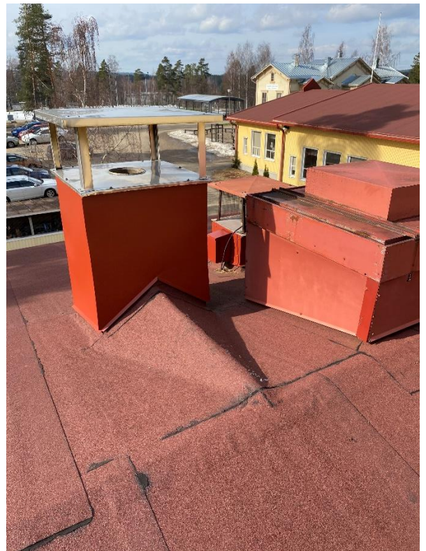
Kuva 39 RAK: Piipun taustan vastakaato ok.
