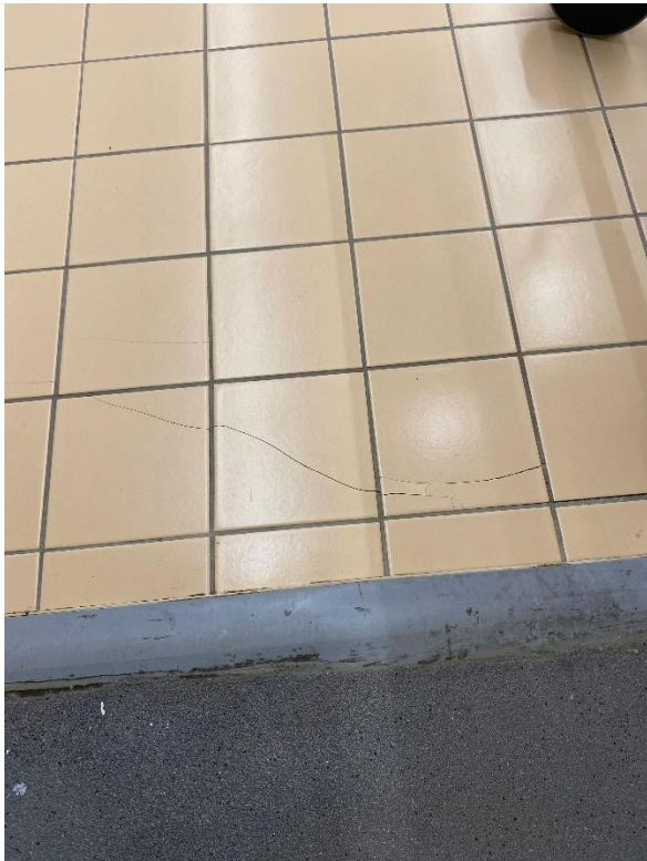
Kuva 34 RAK: Ruokasalin lattialaatat rikki
