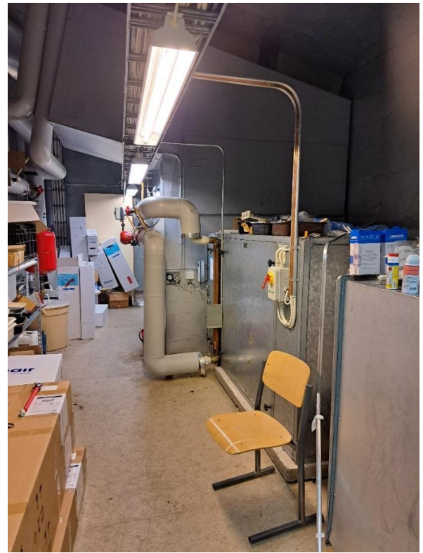
Kuva LVI 7: Luokkatilojen tuloilmakone, takana liikuntasalin tuloilmakone
