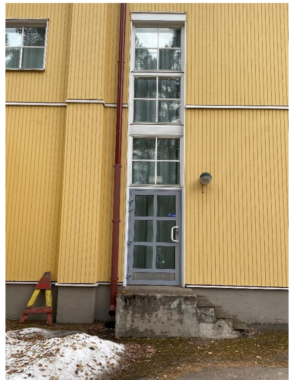
Kuva 12 RAK: Itäisivu; portaan betoni rapautunut
