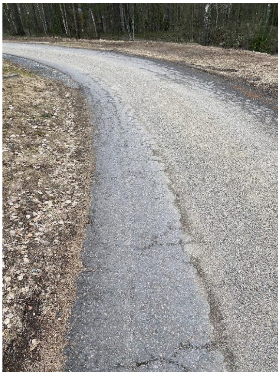
Kuva 11 RAK: Itäisivulla asfalttia halki
