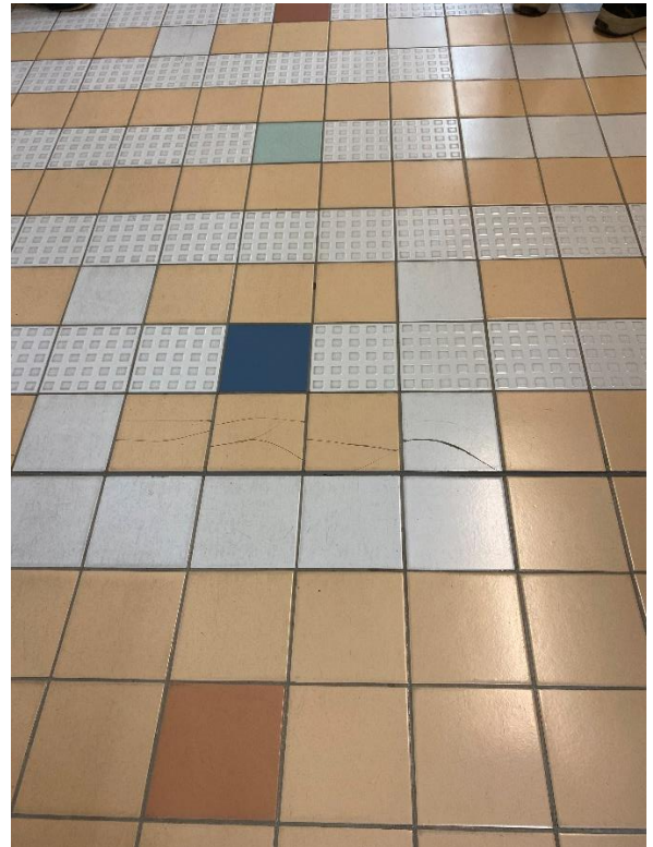
Kuva 35 RAK: Käytävä 184; lattialaatat rikki
