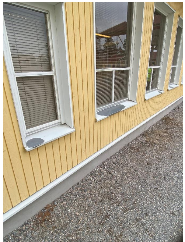
Kuva 2 RAK: Vesipeltien pinnat kuoriutuneet
