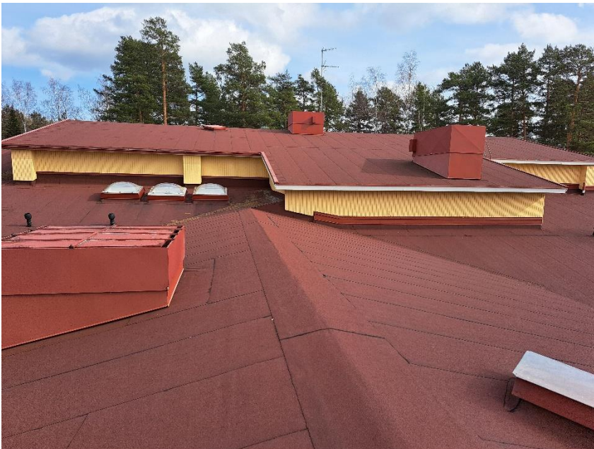
Kuva LVI 8: Lämmöntalteenotolla varustettuja ilmanvaihtolaitteita katolla
