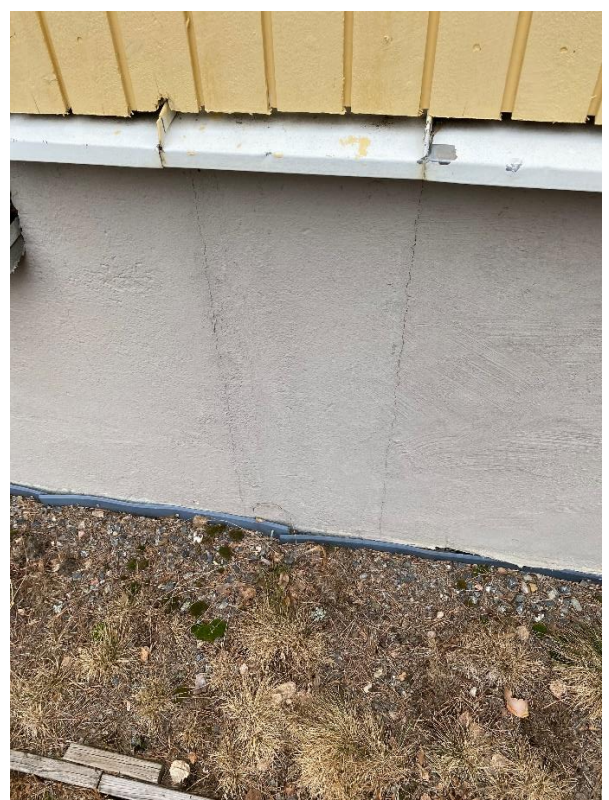
Kuva 8 RAK: Sokkelissa halkeamia; pohjoissivu
