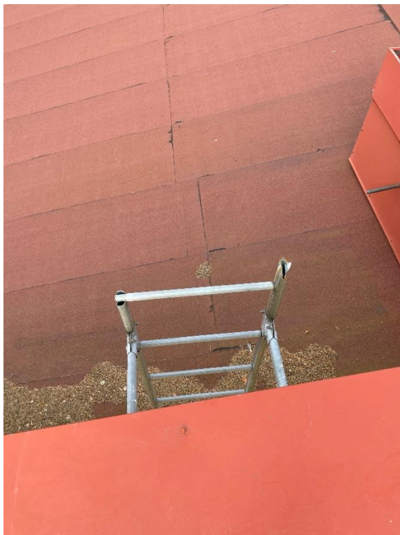
Kuva 49 RAK: Kattotikkaan yläosa mennyt rikki; estää turvallisen kulkemisen ylemmältä katolta alemmalle katolle!
