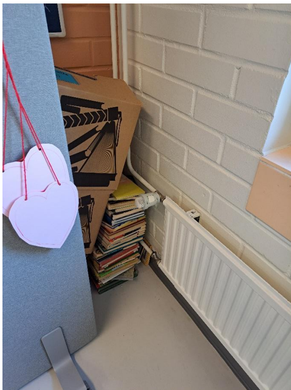
Kuva LVI 3: Lämpöpatteri ja termostaattiventtiili
