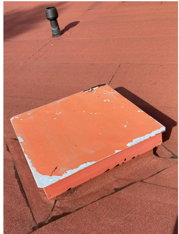
Kuva 41 RAK: Kattoluukun kansi; varmuusketju puuttuu luukuista.
