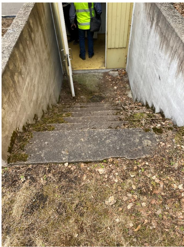
Kuva 7 RAK: Kellarin porras, pinnat huonot
